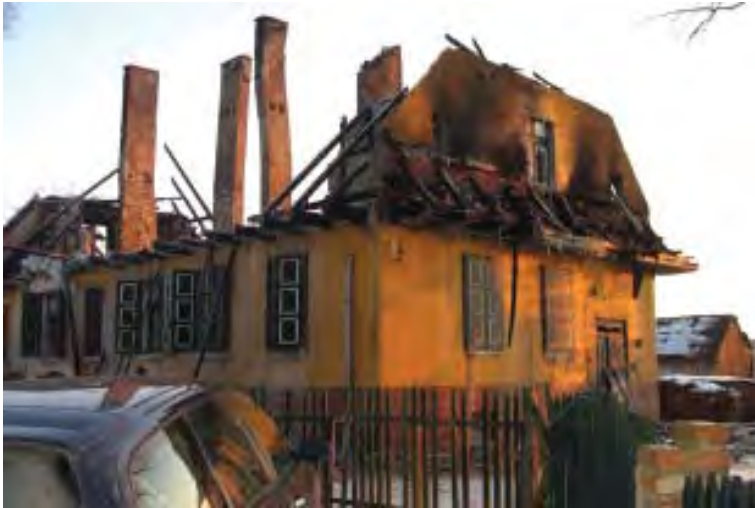
Das Haus nach dem Brand am 2.2.2012
