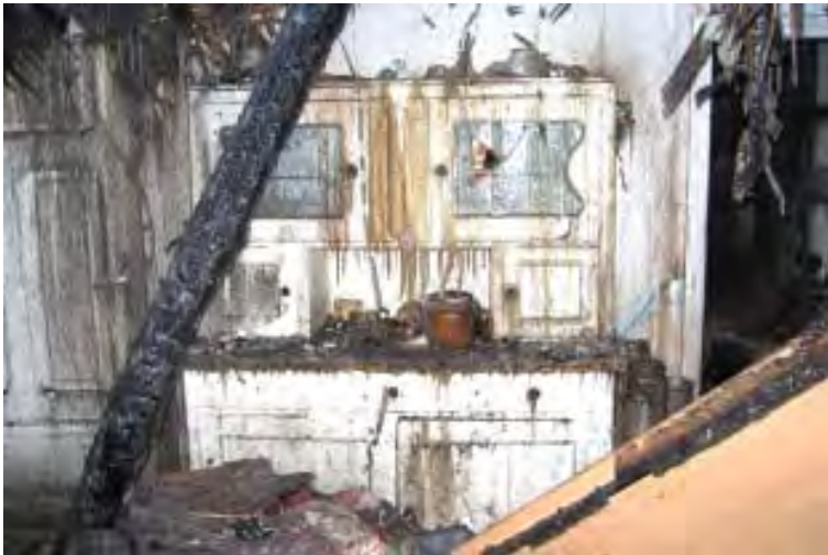
Bäsmanns ausgebrannte Küche
